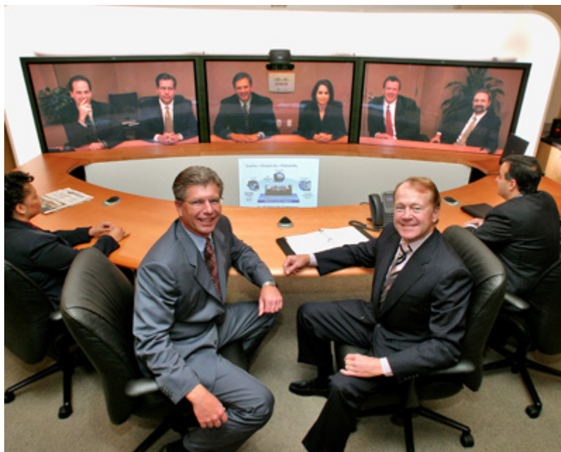
할리우드 영화사에 설치된 시스코 화상회의 시설
